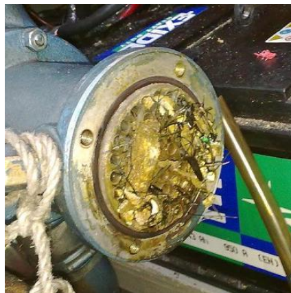
Masser af kalk udfældet i varmeveksler.
